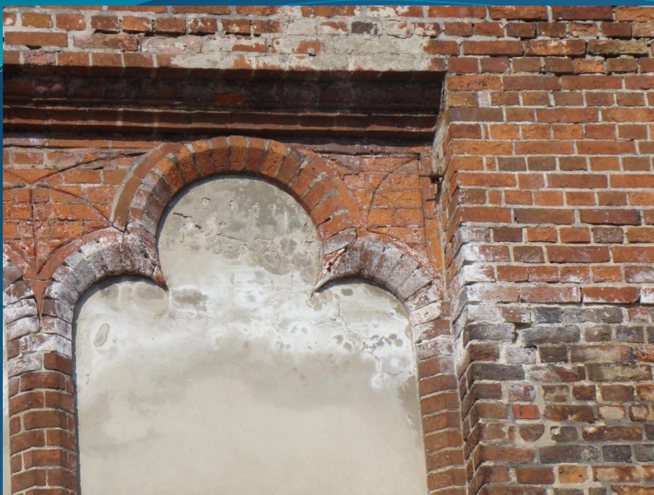
Fragment bramy przy ul. Żeglarskiej z widocznym wysoleniem na murze
