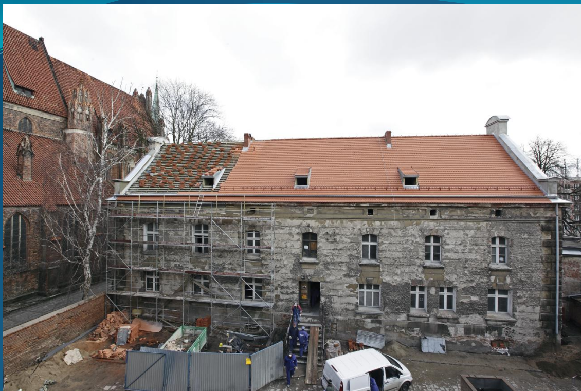
Stan zachowania przed pracami
