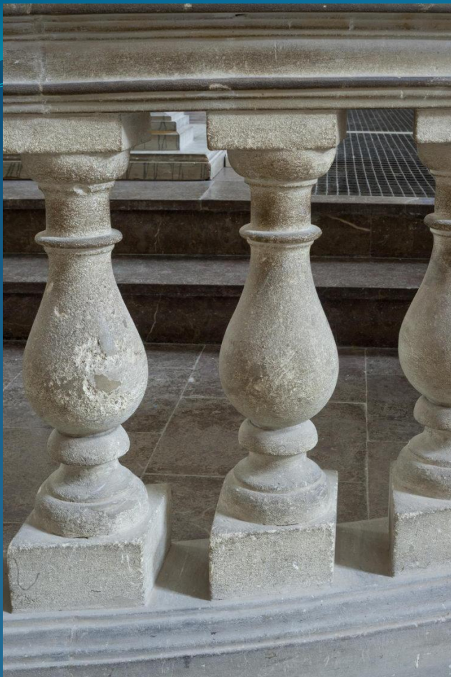
Kamienne tralki balustrady przed ołtarzem głównym kościoła przed pracami konserwatorskimi
