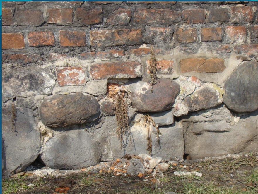
Mur przed pracami konserwatorsko-remontowymi, z widocznymi ubytkami oraz porośniętą roślinnością
